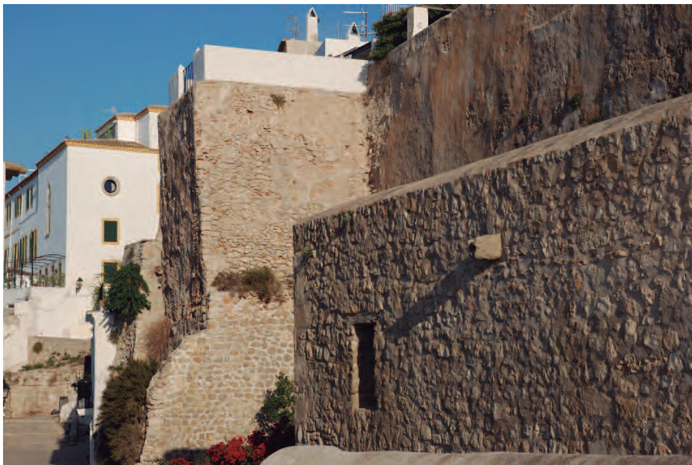
El tram de mur caigut al qual es refereix el Llibre de clavaría de 1373-1374, pertanyia al recinte de la vila mitjana i va precipitar-se sobre el Raval, contigu i situat a cota inferior. Amb tot, la portella d'en Nicolau Ferrer no ha pogut ser ubicada.
