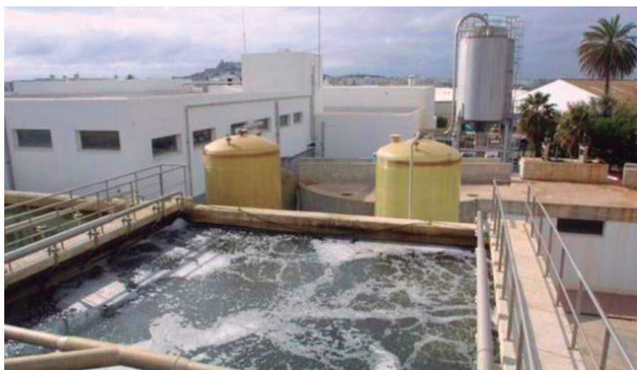
El tractament d'aigües residuals a Eivissa (Fotografia: Fons de Preservació d'Eivissa).
